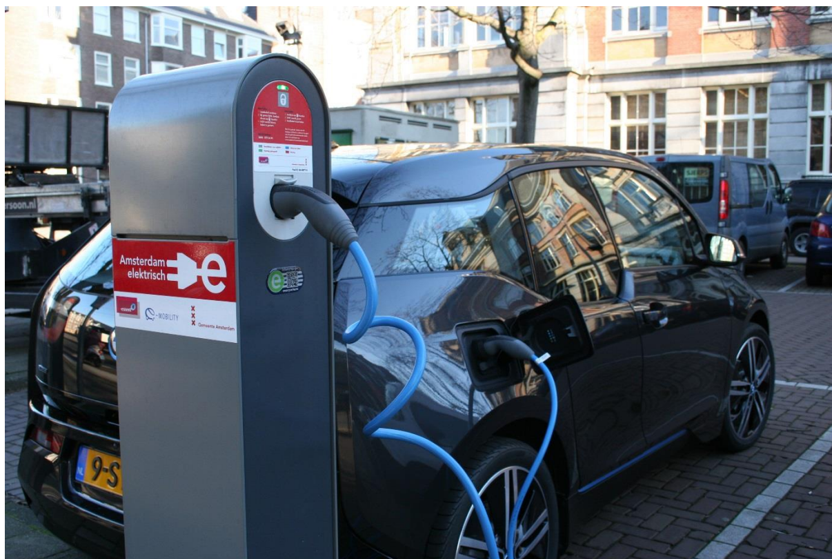
intercharge auf einer Ladestation in Amsterdam
